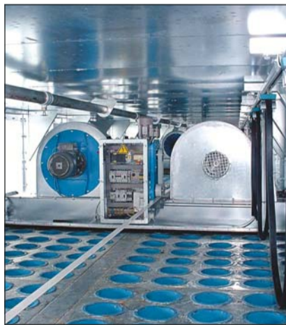
Oczyszczanie filtrów przy pomocy sprężonego powietrza
