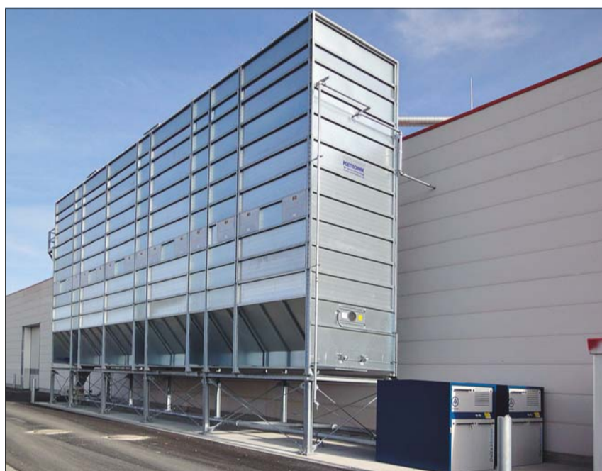
Instalacja odpylania o długości 15 m z oczyszczaniem przewiewowym i przenośnikiem łańcuchowym.
