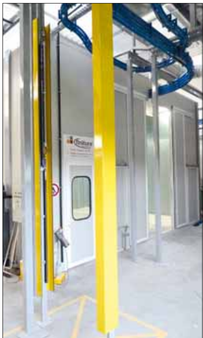
Skaner (żółty) zapisuje wielkości i kształty części przed wejściem do kabiny lakierniczej.
